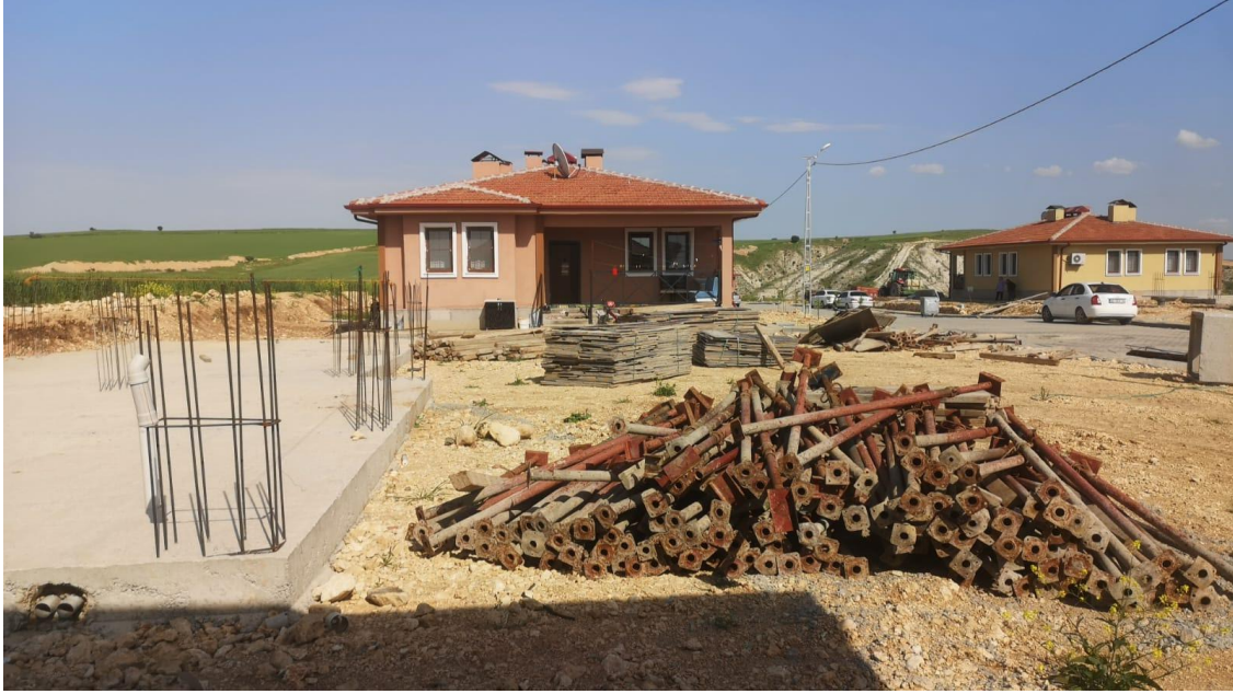
Şekil 4. Altı Şubat Depremleri sonrasında yapılan kırsal deprem konutu ve aynı parsel içerisinde inşa edilmekte olan ahır (Alişar Köyü-Besni)
